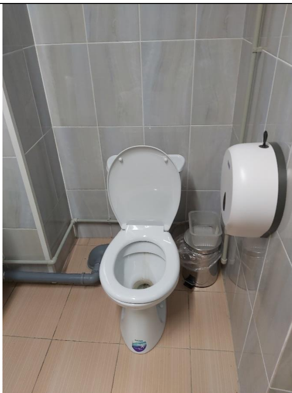
Фото № 71 Внутреннее обустройство туалетной комнаты
