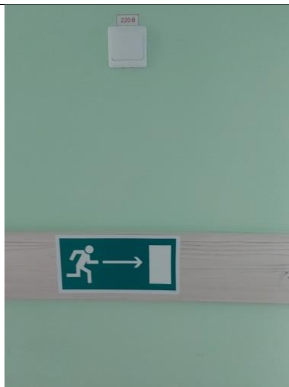
Фото № 30 Эвакуационные указатели путей движения внутри здания
