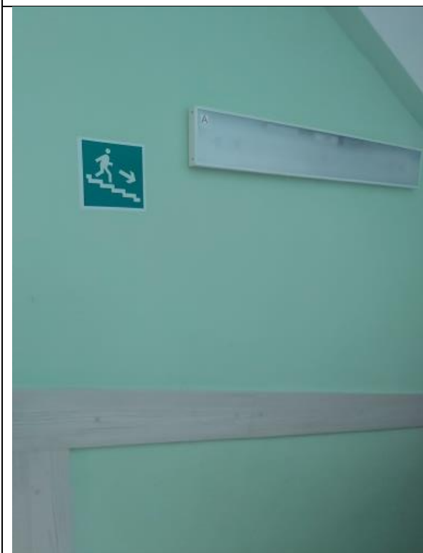
Фото № 31 Эвакуационные указатели путей движения внутри здания
