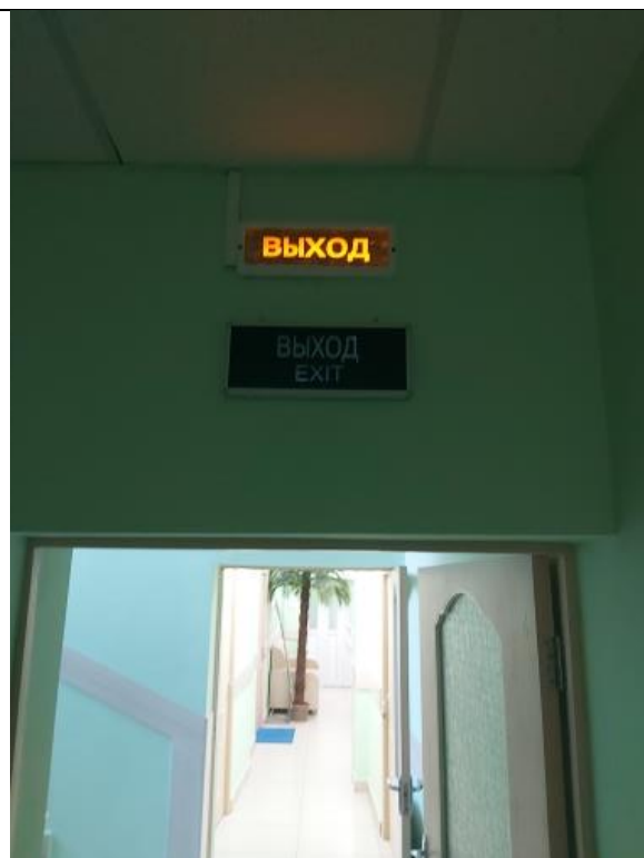
Фото № 33 Эвакуационные указатели путей движения внутри здания
