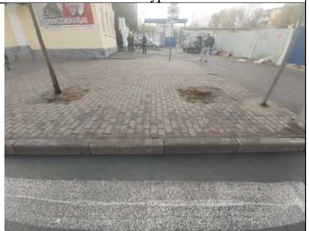
Фото № 82 Перепад высот на наземном пешеходном переходе через проезжую часть ул. Союзная в г. Курске
